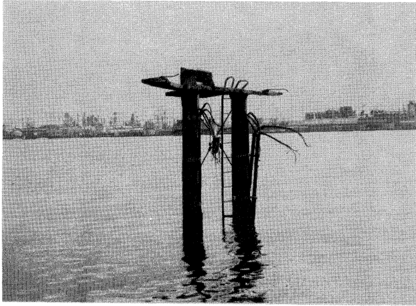
写真 1 0 第 1 4 番進入灯損壊状況（側面）
