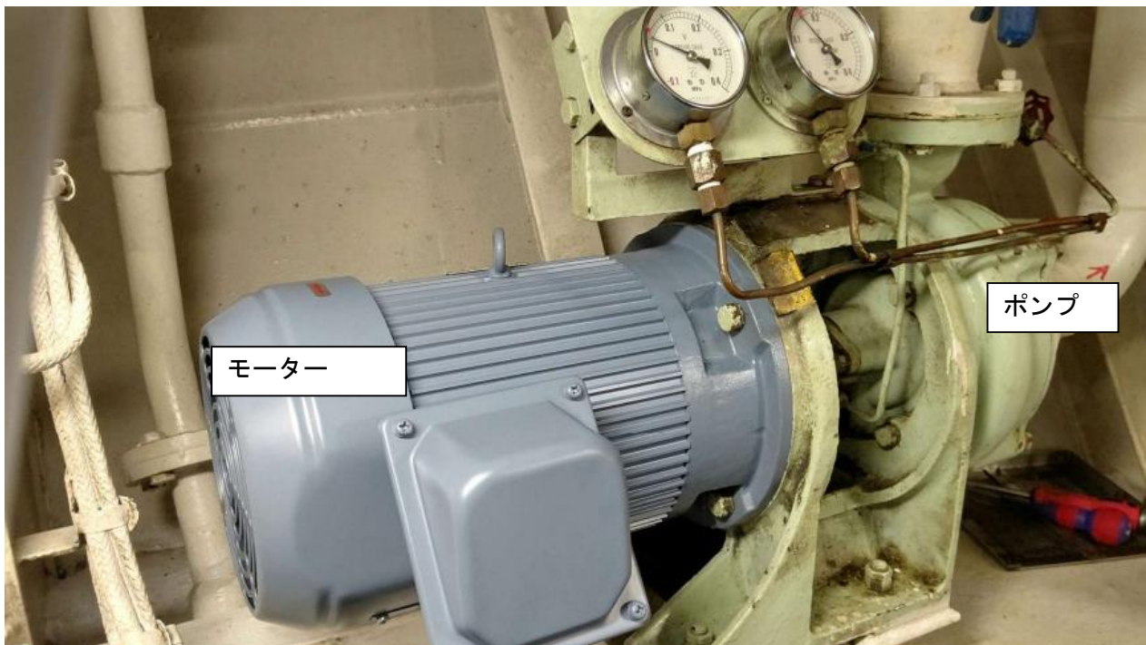
写真1 本件ポンプ及びモーター
