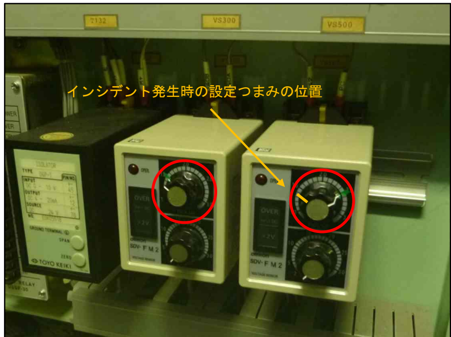
写真2 機関室警報盤下部のボルテージセンサー（復旧後）
