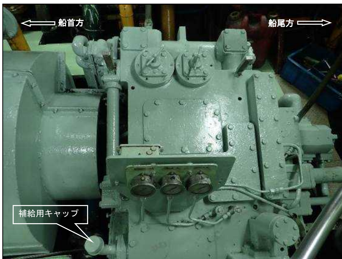
写真2 逆転減速機の外観
