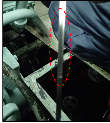
写真3 現場調査における作動油の状態
