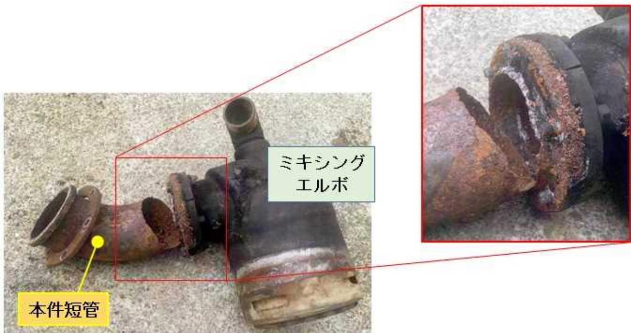
写真1 本件短管破損状況
