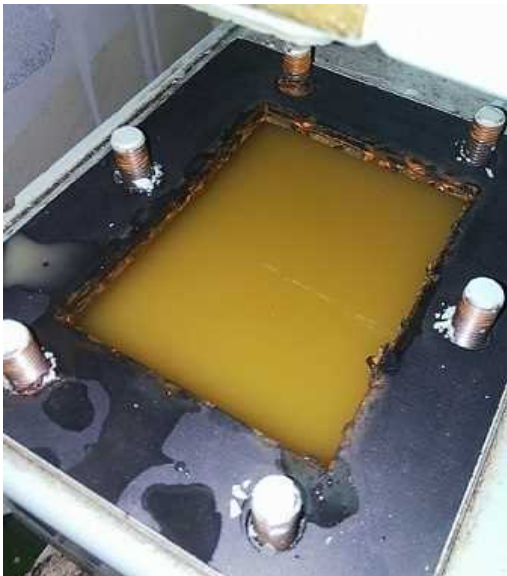
写真1 本件タンク内の作動油の乳化状況及び発錆状況
