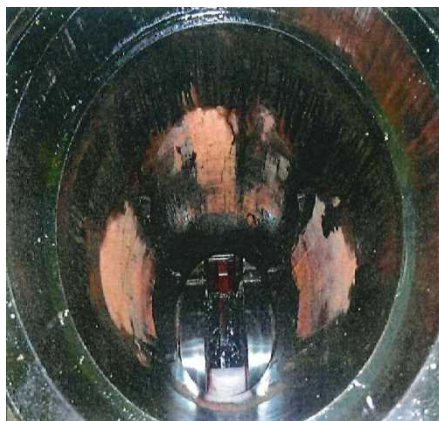
写真3 ライナ内面の損傷
