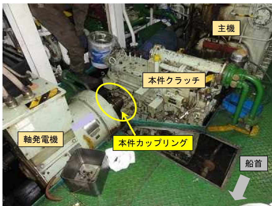
写真 1 主機、本件クラッチ及び軸発電機の配置
