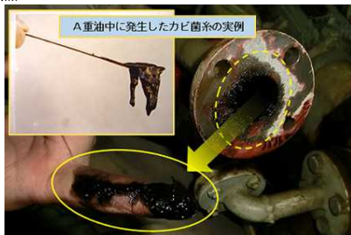
写真1 本件スラッジ堆積状況（燃料油供給配管内）
