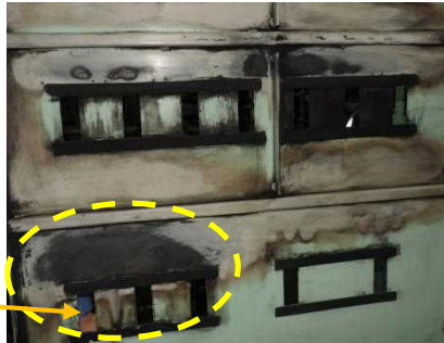
440V給電盤裏面の焼損 本文(6)に対応
