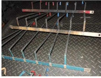
分岐線の被覆の焼損 本文(6)に対応
