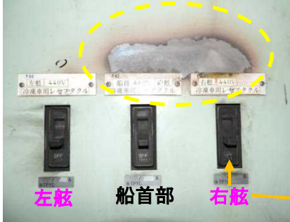
440V給電盤表面の焼損 本文(6)に対応
