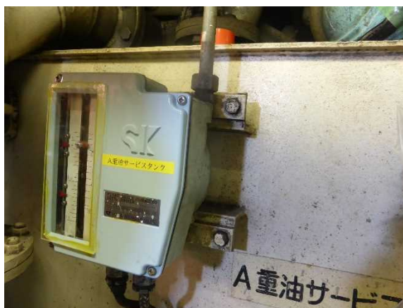
写真3 A重油サービスタンクの本件フロートゲージ
