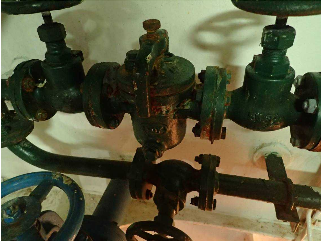
写真3 船尾管注水管
