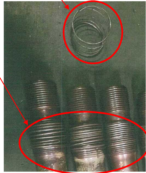
写真2 破損した植込ボルトのねじ部
