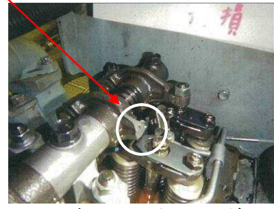
写真2 6番シリンダ ロッカーアーム折損状況
