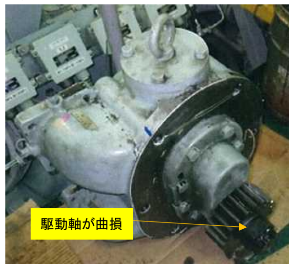
写真10 主機直結潤滑油ポンプの状況
