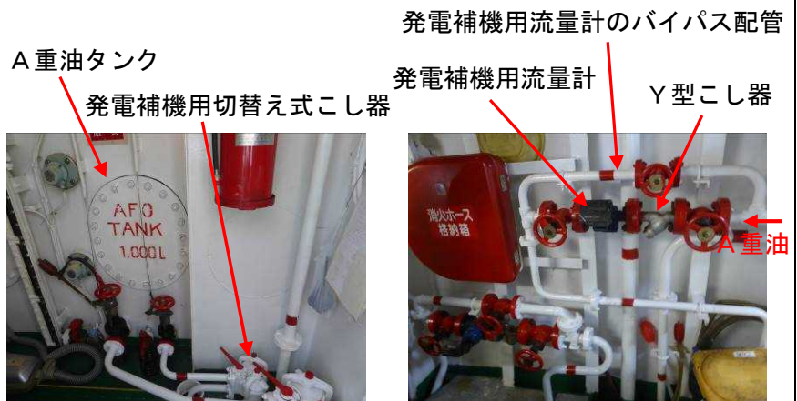
写真 1 A重油タンク及びこし器
