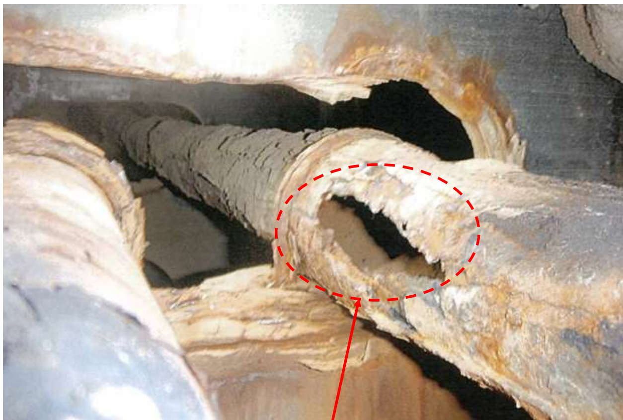
写真1 5番バラストタンクを貫通する4番バラスト管の破口の状況
