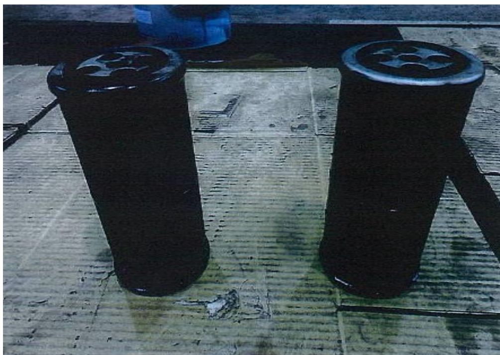
写真1 主機の潤滑油こし器エレメントの汚損状況
