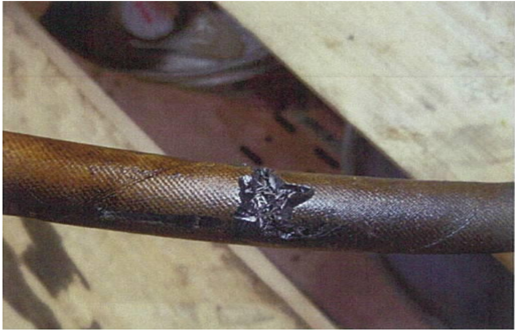
写真1 本件圧力計配管の破損状況
