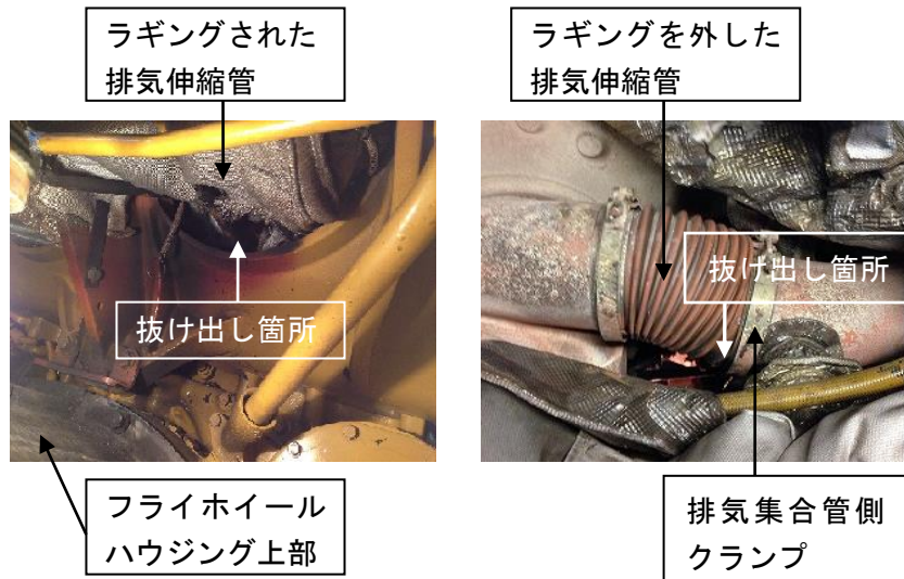
写真1 排気伸縮管抜け出し箇所①
