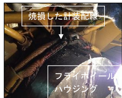
写真4 計装配線の焼損状況
