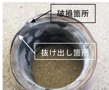
写真3 排気伸縮管の損傷状況
