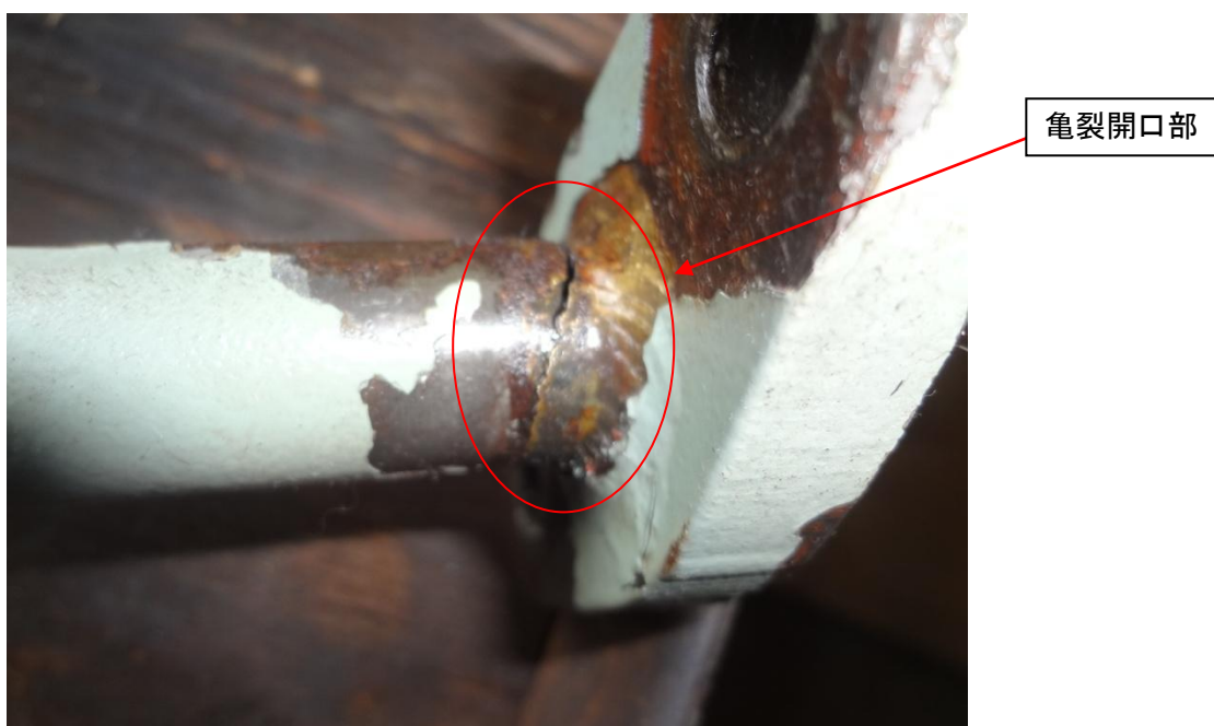
写真2 本件抜き出し管亀裂開口部
