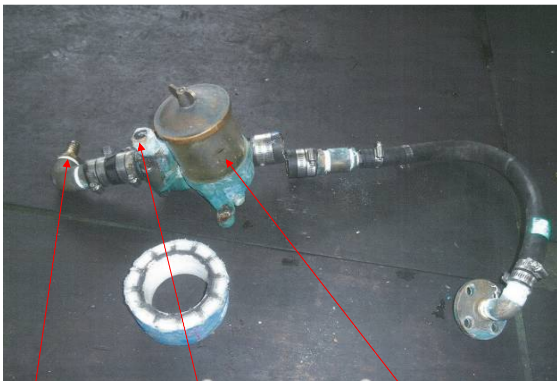
写真6 本件冷却海水管の状況
