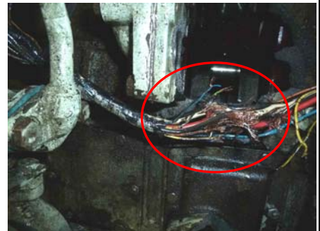
写真2 電線切断状況
