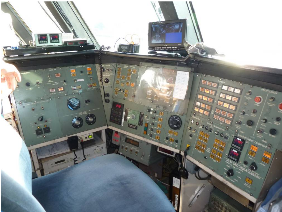
写真2 操舵室内の機関監視盤
