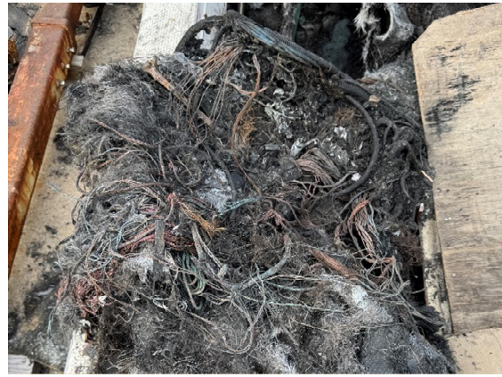
写真14 配電盤に接続されていたと考えられる電気配線（本事故当日撮影、漁協提供）
