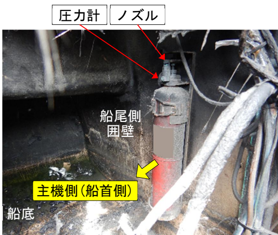
写真16 自動拡散型消火器の状況
