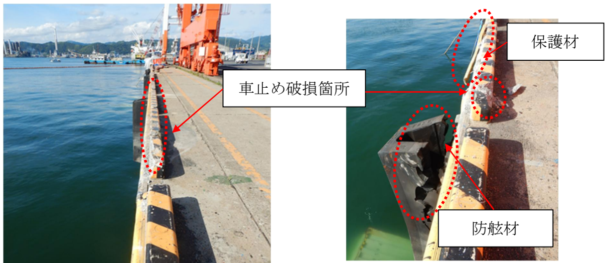
写真11 本件岸壁付近の損傷状況
