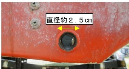
写真3 本件排水口 (ドレンプラグを外した状態)
