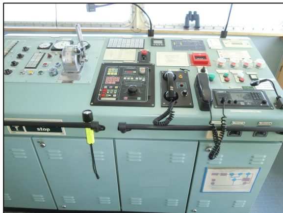
主機遠隔操縦装置等
