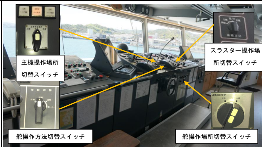
図1 中央操船コンソール、主機操作場所切替スイッチ等
