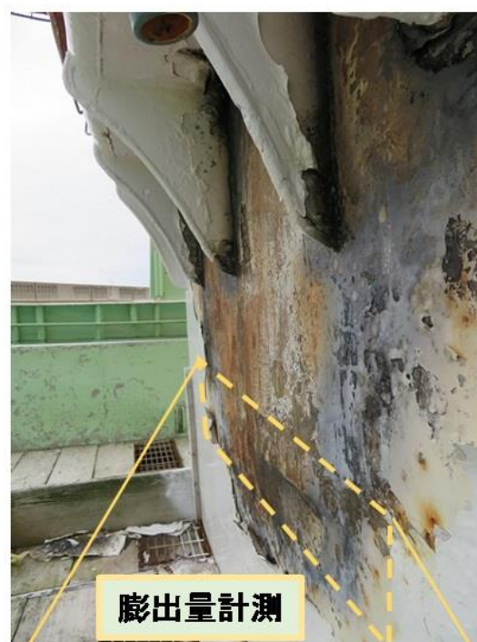
写真4 操舵室下の船首側壁面の状況
