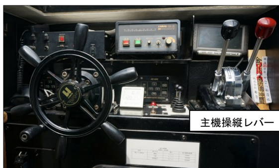
写真2 操船区画内の操縦装置
