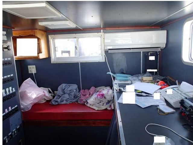
写真4 本船操舵室内の空調機（室内機）
