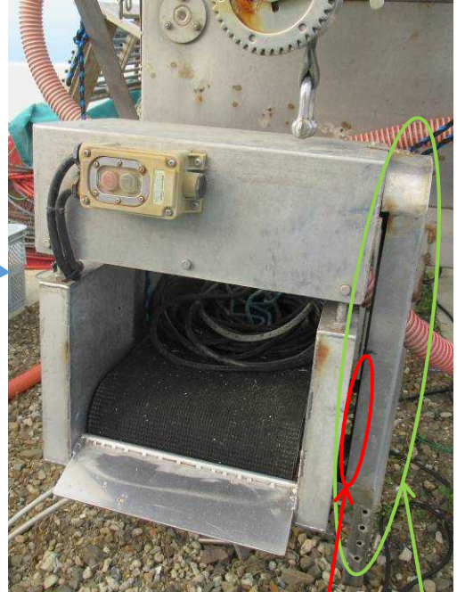
写真4 ベルトコンベア排出口
