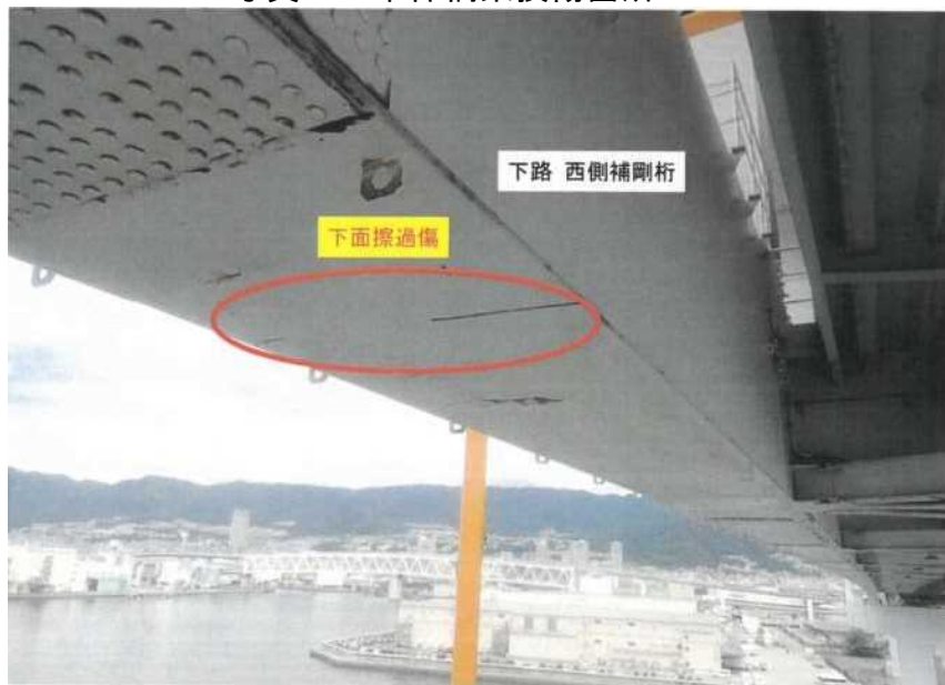
写真3 本件橋梁損傷箇所1
