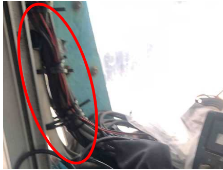
写真6 無線装置等の配線
