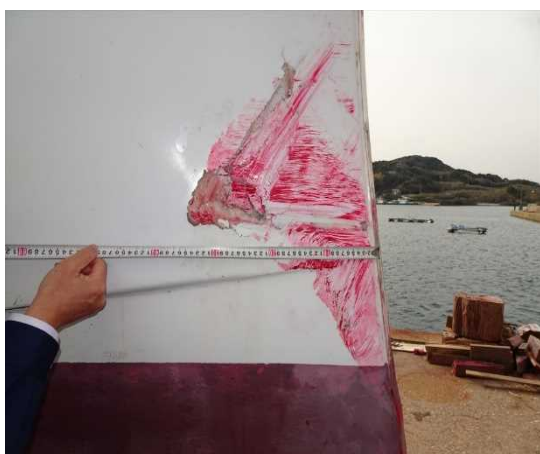
写真3 A船の損傷状況③ (船首部右舷)
