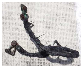
写真13 バッテリー間の接続に使用されていたケーブルの焼損状況
