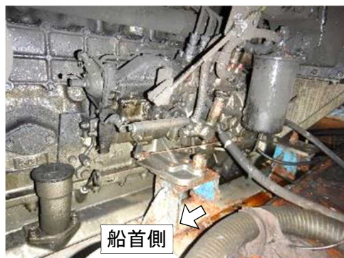
写真7 主機左舷側の状況
