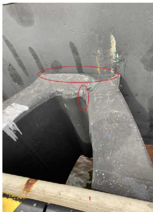
写真5 ゴム製防舷材の損傷状況
