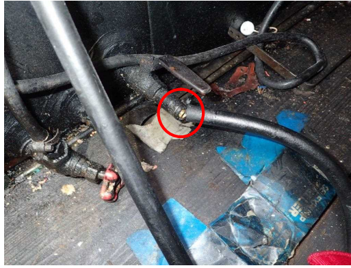
写真6 本件燃料油ホースの破断状況
