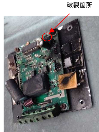
写真5 本件チャージコントローラ内部
