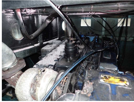
写真3 本事故後の機関室（主機周辺）の状況
