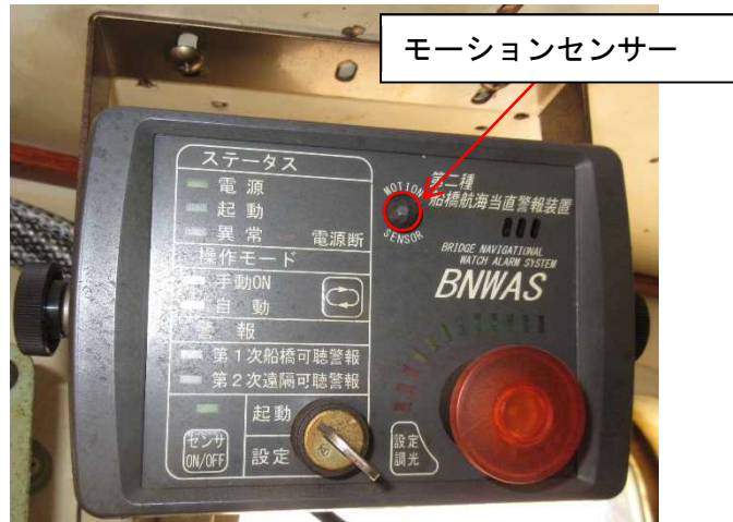
写真3 本件警報装置の操作パネル
