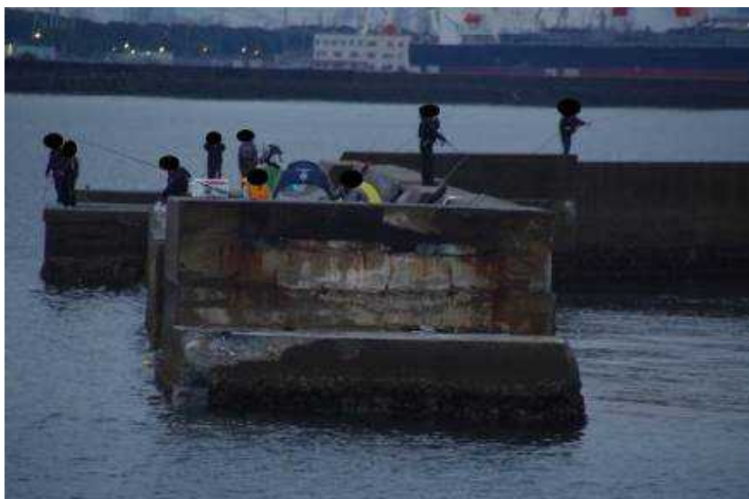
写真2 本事故後の赤灯台付近（海上保安庁提供）
