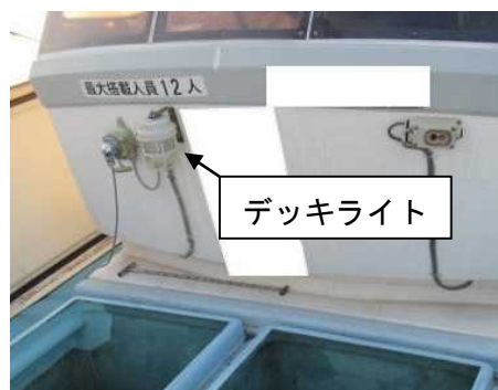
写真5 デッキライト
