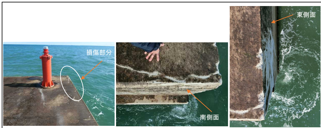
写真2 本件防砂堤の損傷状況
