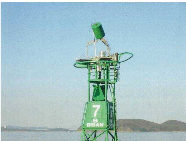
写真3 本件灯浮標の損傷状況 (1) (防護枠等の曲損状況)
