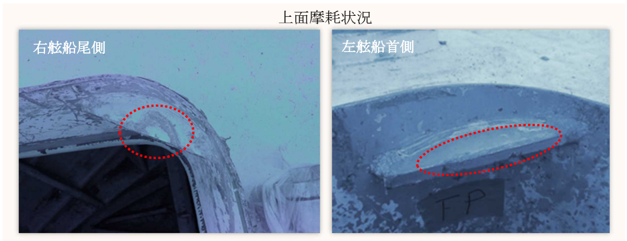
写真21 船首甲板部ハッチクリップ止め部の摩耗状況
