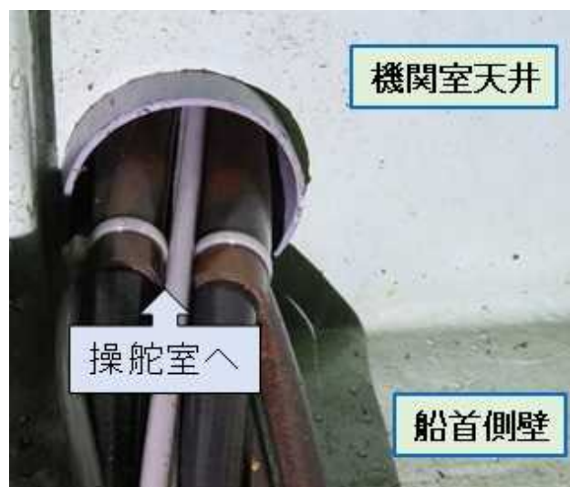
写真5 配線状況（操舵室－機関室間） （機関室側より撮影）
