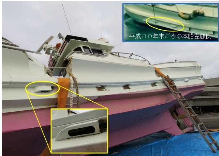
写真3 本件排水孔（左舷船首側）
