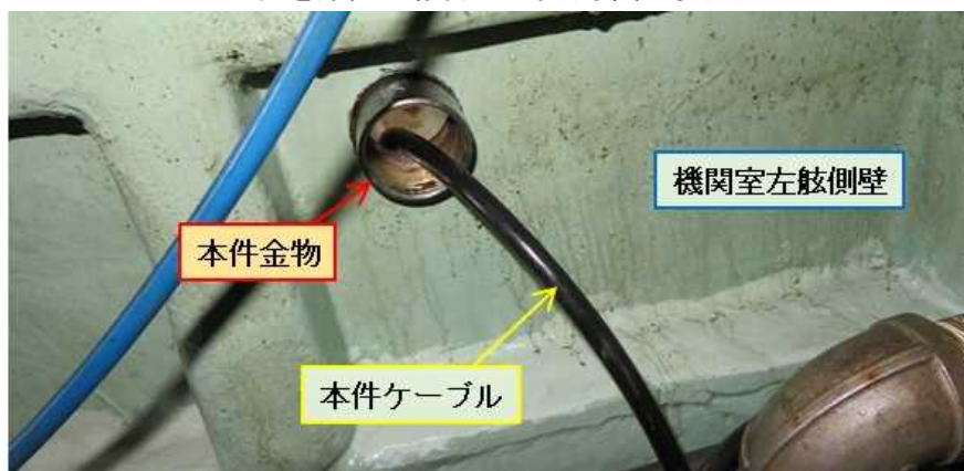
写真1 機関室内から見た本件金物及び本件ケーブル
