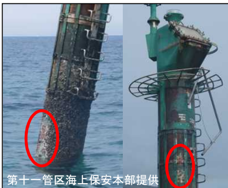
写真3 第1号灯標の損傷状況
