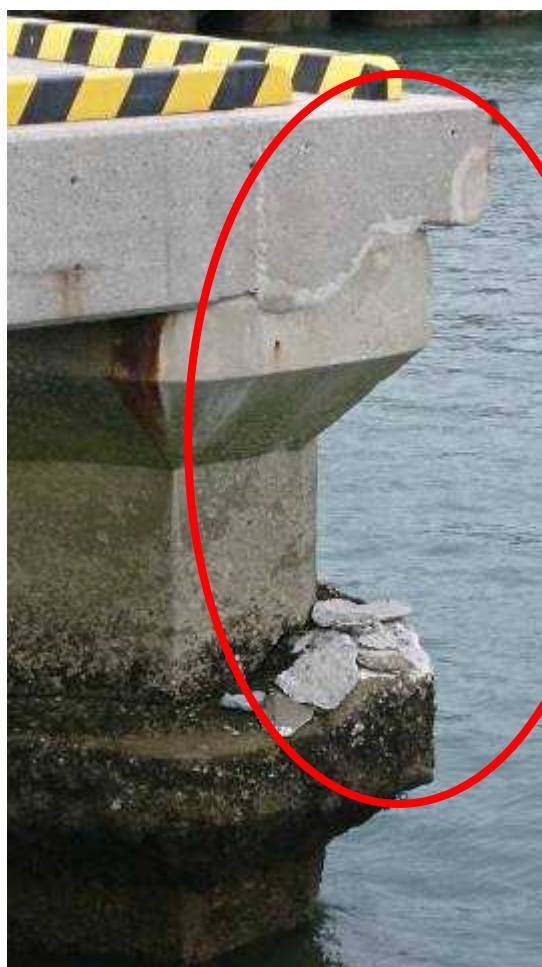
写真6 本件岸壁の損傷状況
