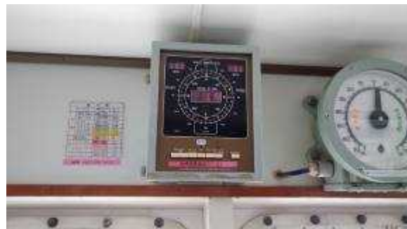
写真4 風向風速表示盤
