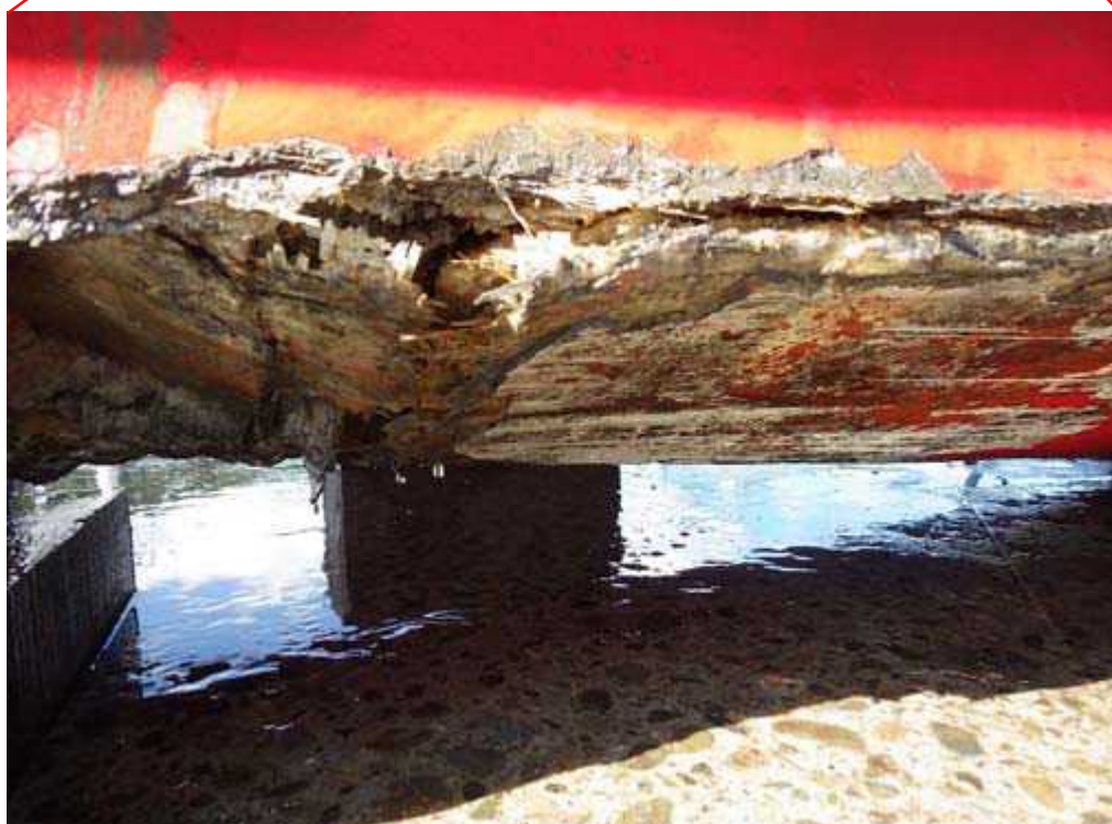
写真2 本船の損傷状況
